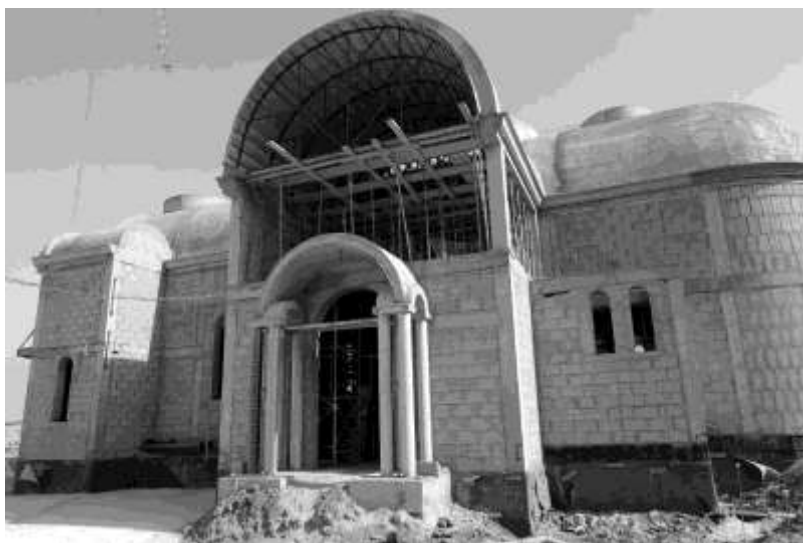
Figura 26. Estado de la construcción de la iglesia ortodoxa rusa de Adeje, junio de 2020 (foto de Sergio Pou)
